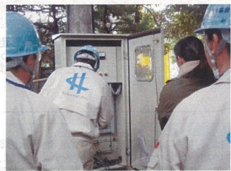
井戸施設における各種点検を行う協会員=県庁前公園内
